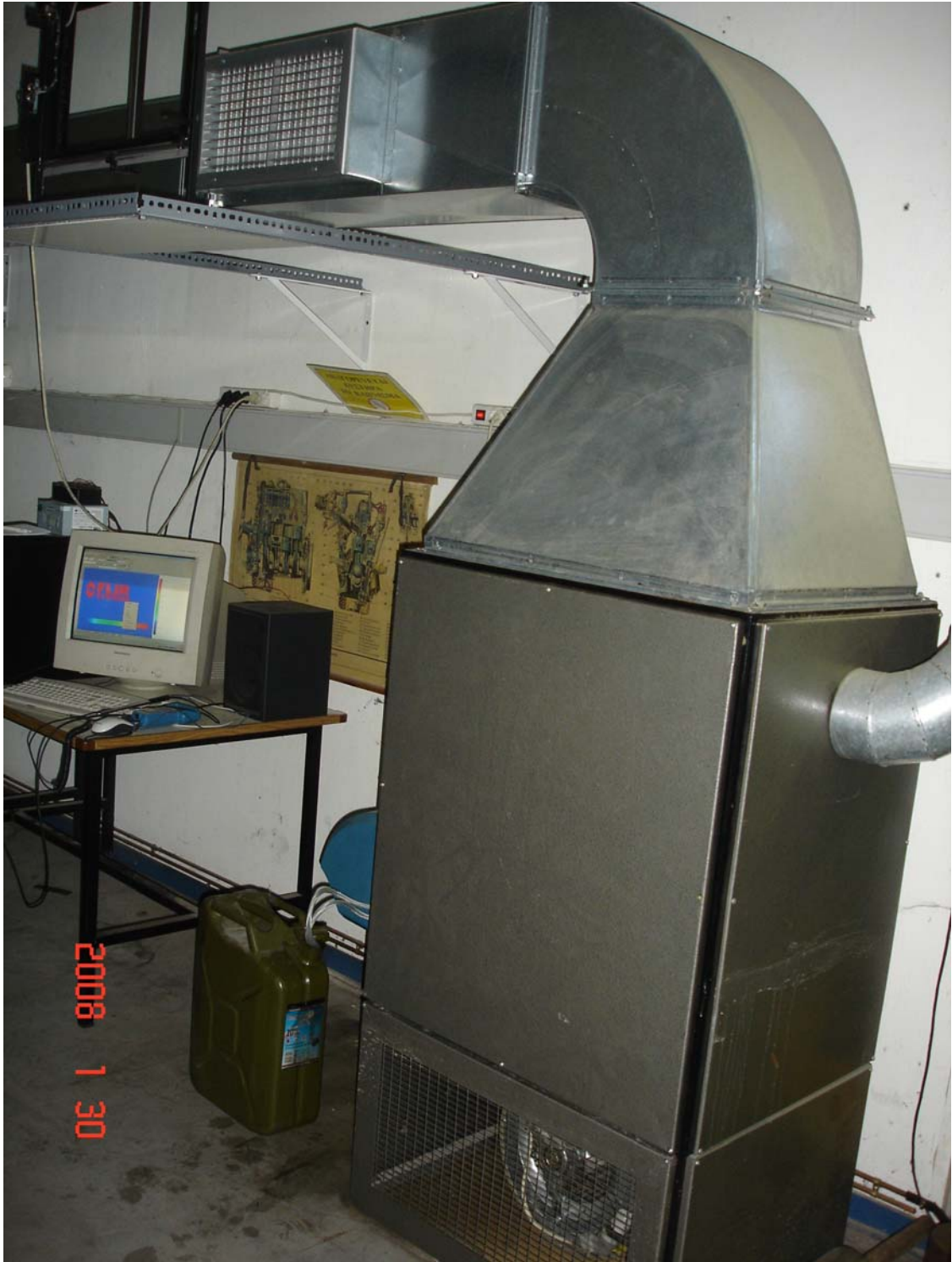
Εικόνα 1 Ο αερολέβητας ισχύος 35,000 kcal/h (κλειστός)
