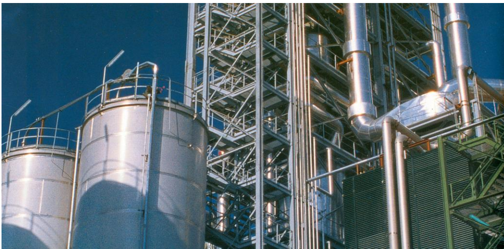
Εικόνα 2: Πύργος παραγωγής και σιλό αποθήκευσης
